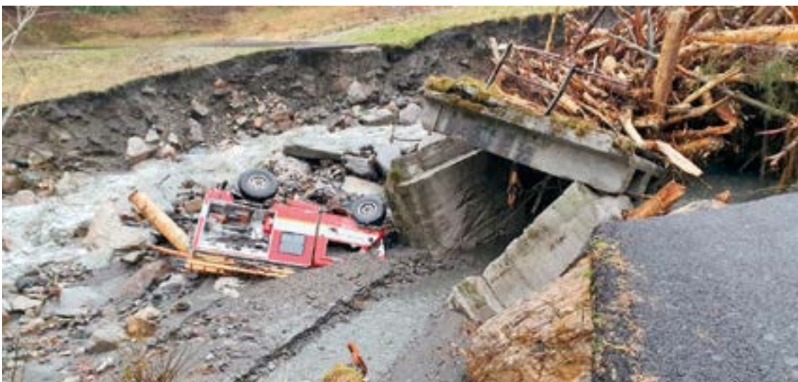
Il ponte di Ren crollato nel dicembre 2020 con il mezzo dei Vigili del fuoco nel torrente.
